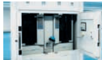
機内持ち込み制限品搬送のエアシューター
