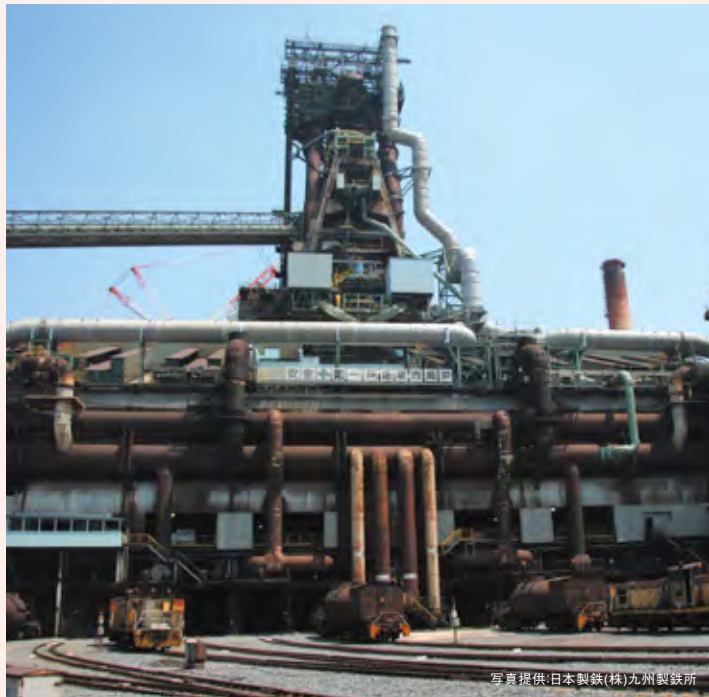
写真提供:日本製鉄(株)九州製鉄所
